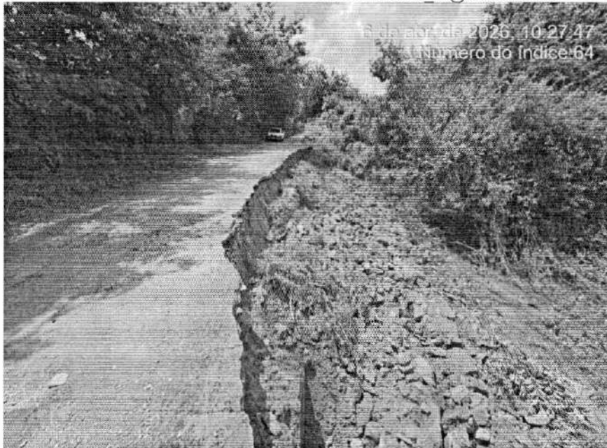
Foto 03 – Muro de Contenção Danificado
