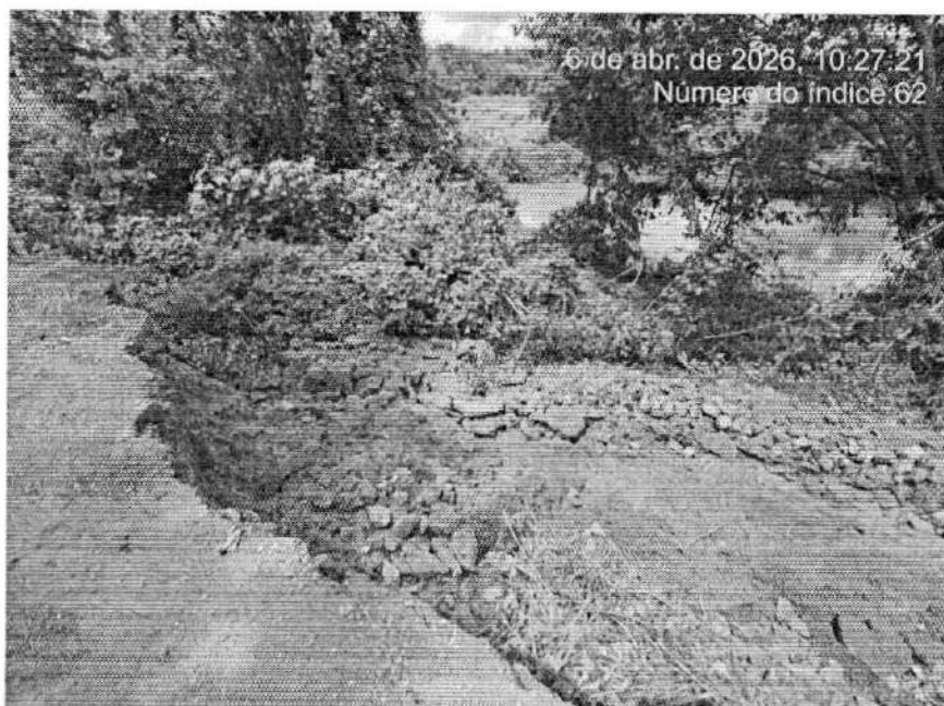
Foto 01 – Muro de Contenção Danificado
